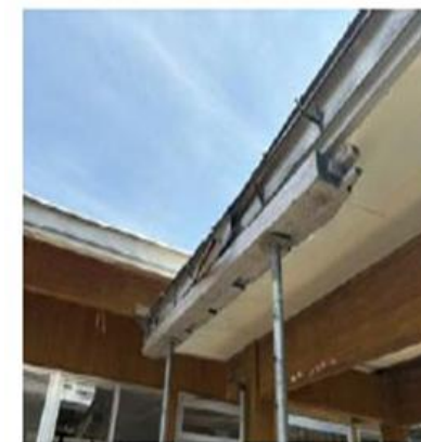
被害及び応急処置の状況
